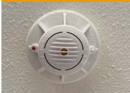
Foto 4.1 Rookmelder aan het plafond
