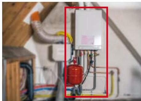
Foto 1.1 Hr-ketel op zolder
