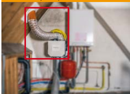
Foto 2.1 Ventilatiesysteem op zolder
